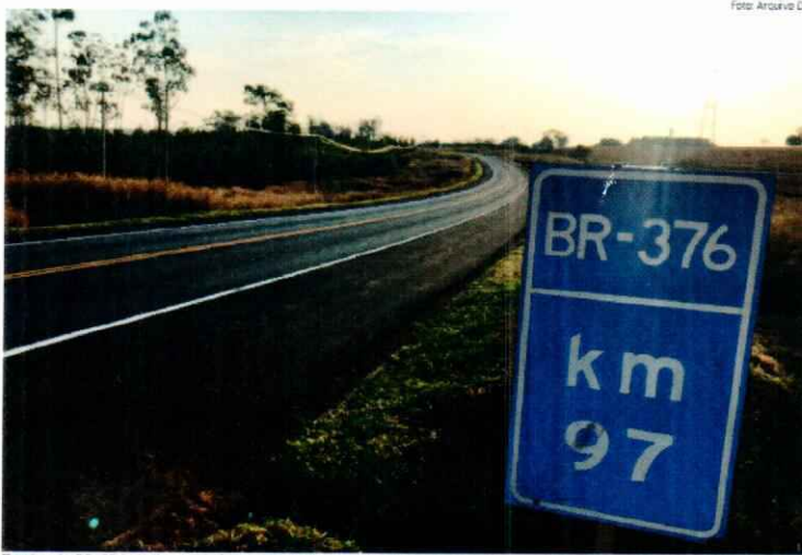
Trecho da BR-376 de Paranaí a Nova Londrina, com pista simples e alguns pontos com terceiras faixas. Tem aproximadamente 77 quilômetros
