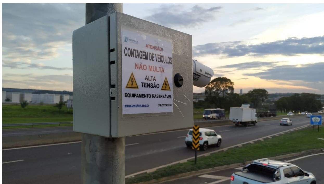
Figura 2.1a – Instalação de Equipamentos de Monitoração em Vídeo
